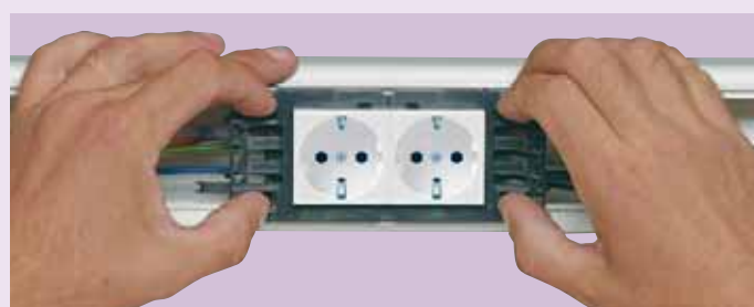
Монтаж розеток Mosaic в кабель-каналы DLP
